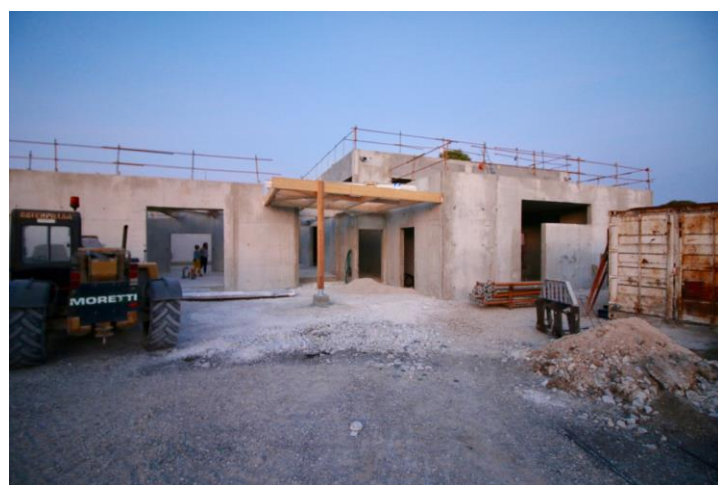
Avancement de la construction du bâtiment cantine et associations au 19/09, les travaux de génie-civil et de charpente sont achevés, la couverture est en cour.
